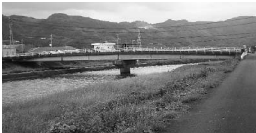
耐震の調査を待つ香宗川に架かる橋
