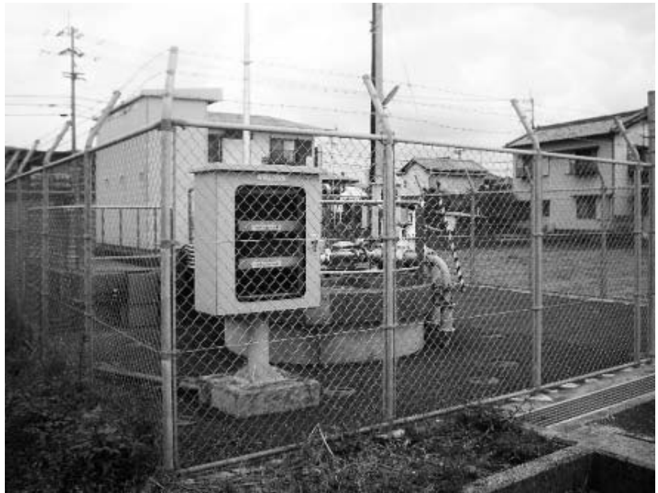
工業用水ポンプ場
