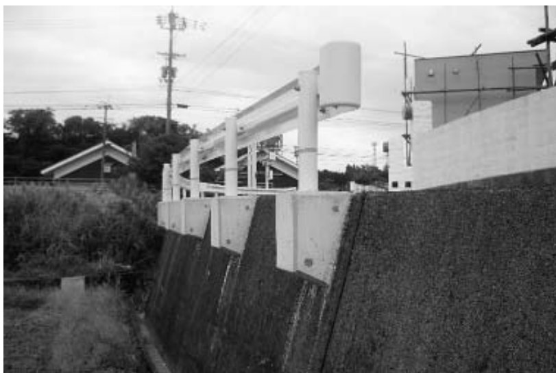
危険力所に設置したガードレール
