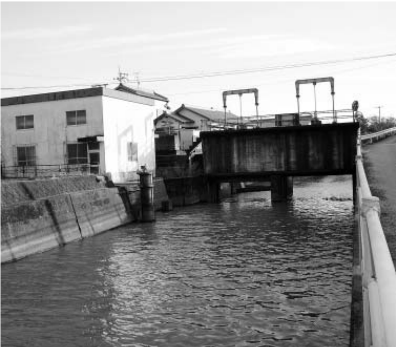
東部排水機場
