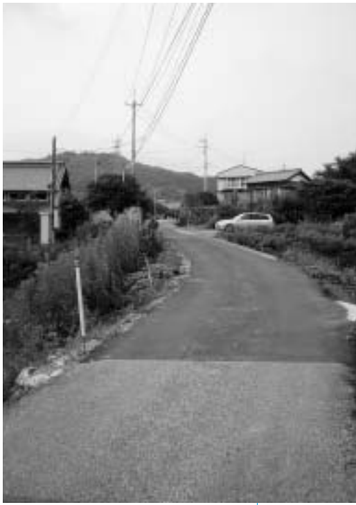
整備が済まずに移管されようとした県道
