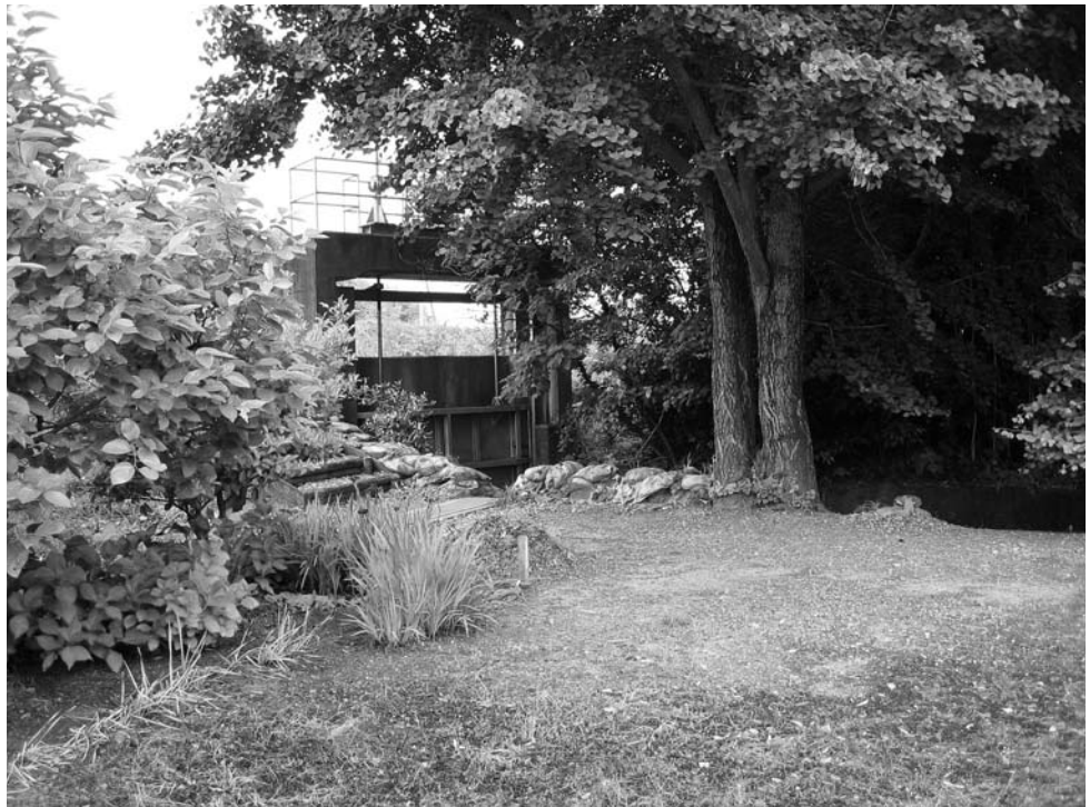
整備が待たれる横井地区水門
