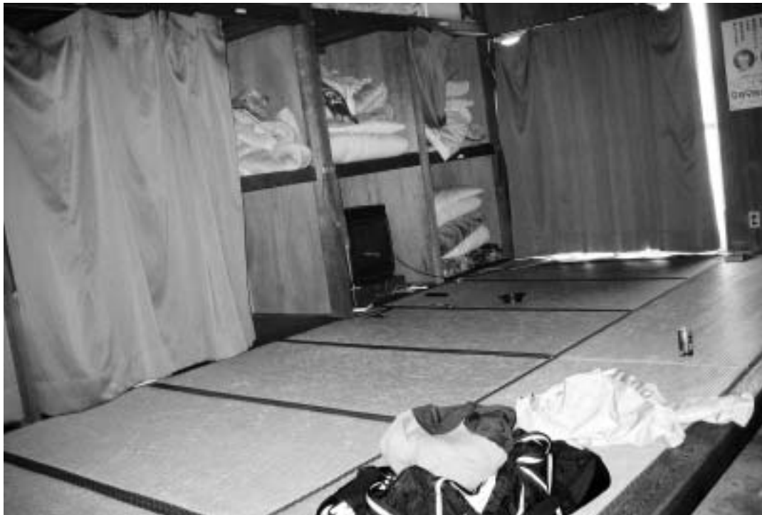
早急な改築が望まれる消防庁舎(仮眠室)
