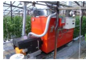
木質バイオマスボイラー
