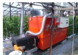
木質バイオマスボイラー
