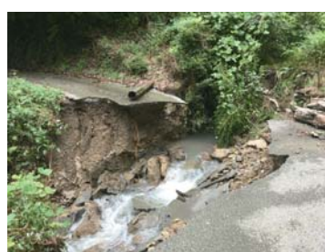
▲7月豪雨で寸断された道
