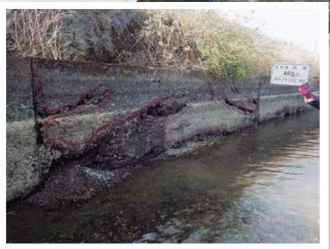
▲コンクリートの劣化が目につくところも…
