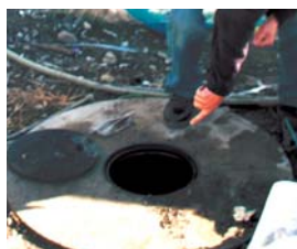
▲ビニールハウスの雨水浸透枮
