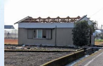
▲被害にあった新道公民館
