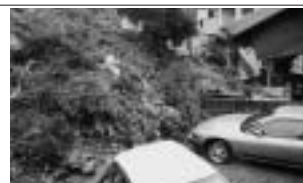
▲白岩団地では、がけが崩れブロック塀を壊し車11台を押しつぶした
