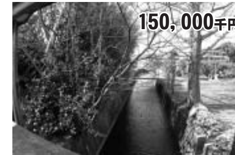
豪雨時に水が溢れ出す水路
