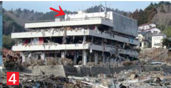
4 震災後の女川町役場。写真矢印は鈴木氏が避難した庁舎の屋上。
