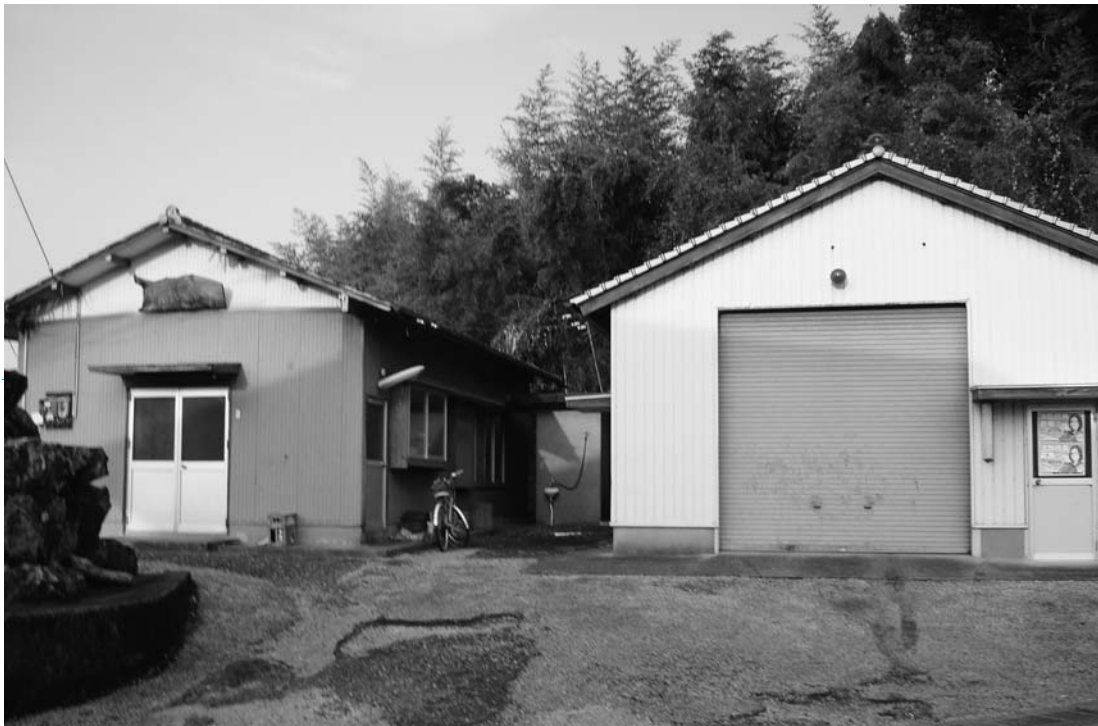
老朽化した山北消防屯所
