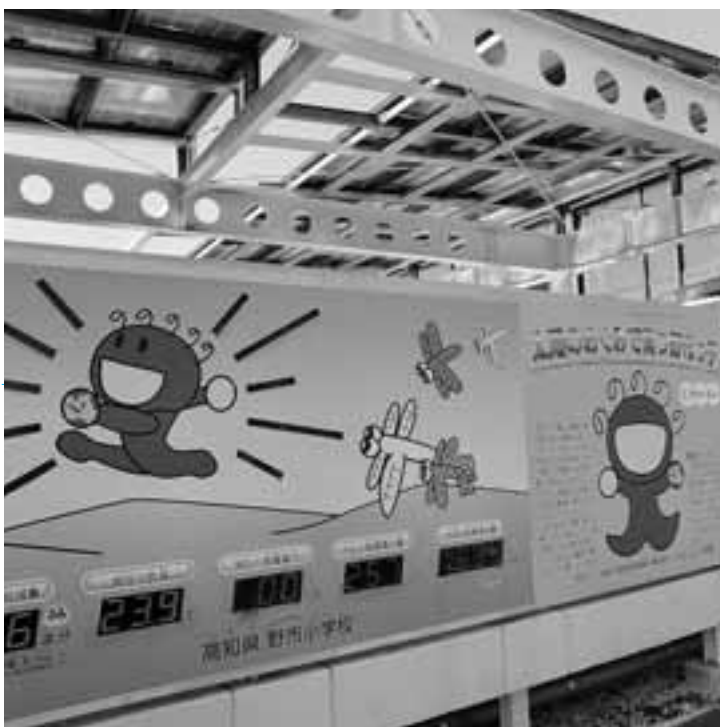
野市小学校プールの太陽光発電装置
