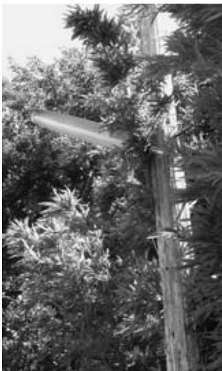
木柱に設置の防犯灯
