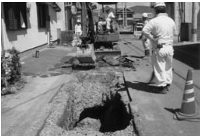
陥没した道路
