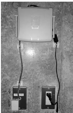
災害時特設公衆電話モジュージャック
