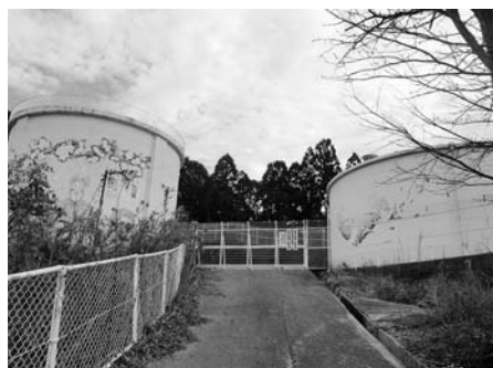
野市町第2 & 3 配水池
