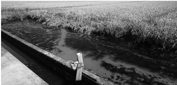
香我美町徳王子地区の破損箇所あり水路
