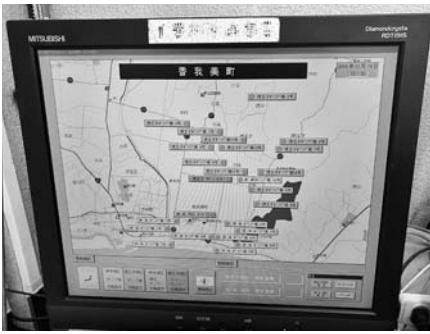
現在の警報監視装置システム
