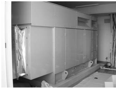
新庁舎非常用発電機
