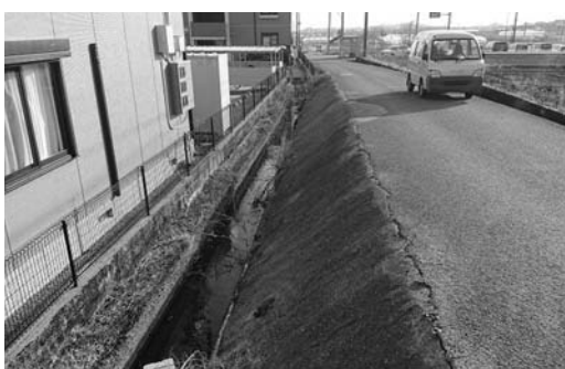
水路危険箇所
