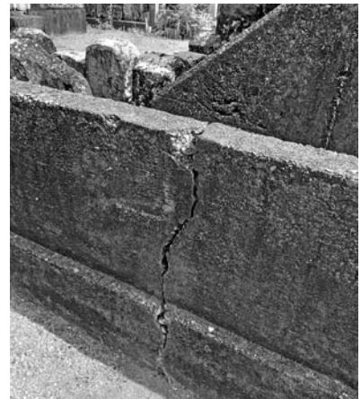
南側塀クラック
