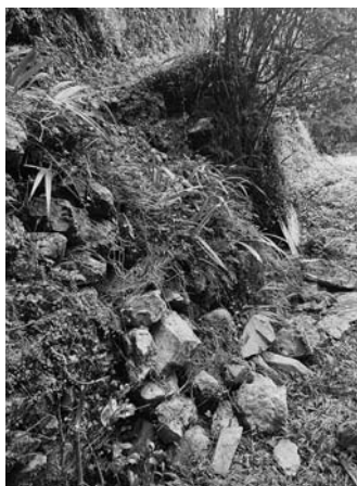
崩落した石垣
