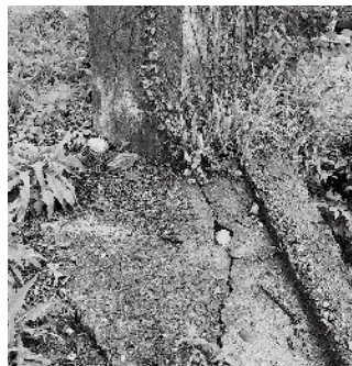
歴史の丘公園の亀裂箇所
