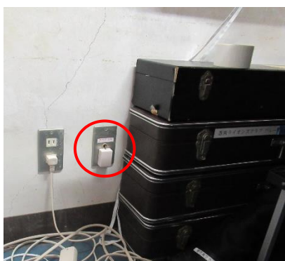
災害時特設公衆電話接続端子
